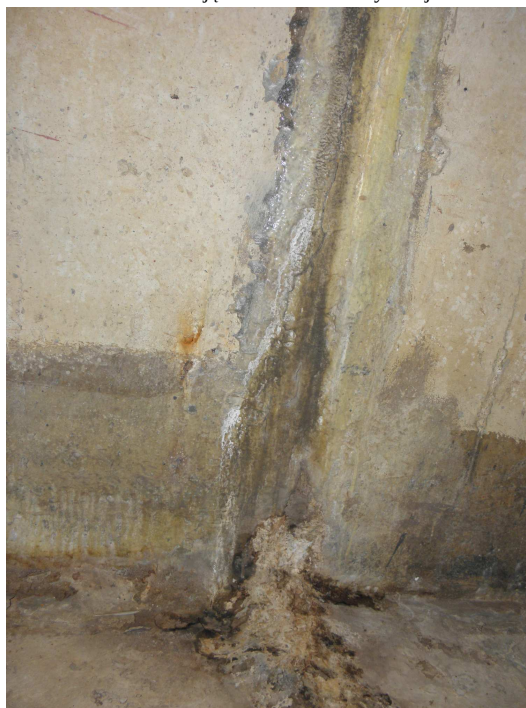
Foto 30 Przeciekające uszczelnienie dylatacji kanału
