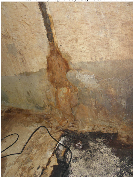
Foto 29 Inny fragment dylatacji na ścianie kanału
